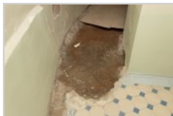
Отсутствие плиты пола и мокрая, прелая земля в месте утраты плиточного покрытия.
