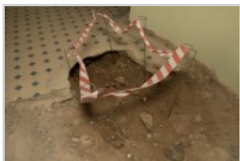
Отсутствие плиты пола и мокрый песок в месте утраты плиточного покрытия.
